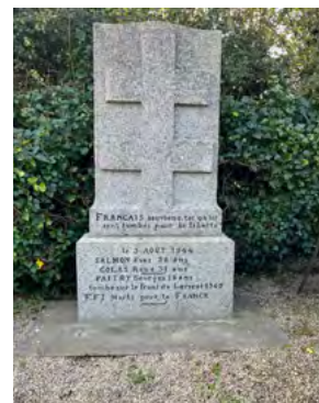
Nettoyage et réparation du monument FFI, croisement de la route du Guildo et de la rue du Vieux Château
